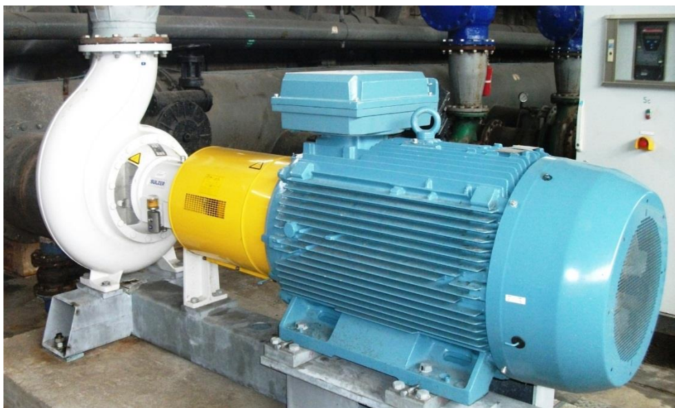
Pompa wody sptawiakowej
